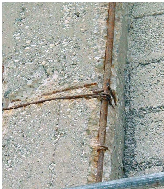
DÉGRADATION DE L'ENROBAGE DANS UN PILIER EN BÉTON
