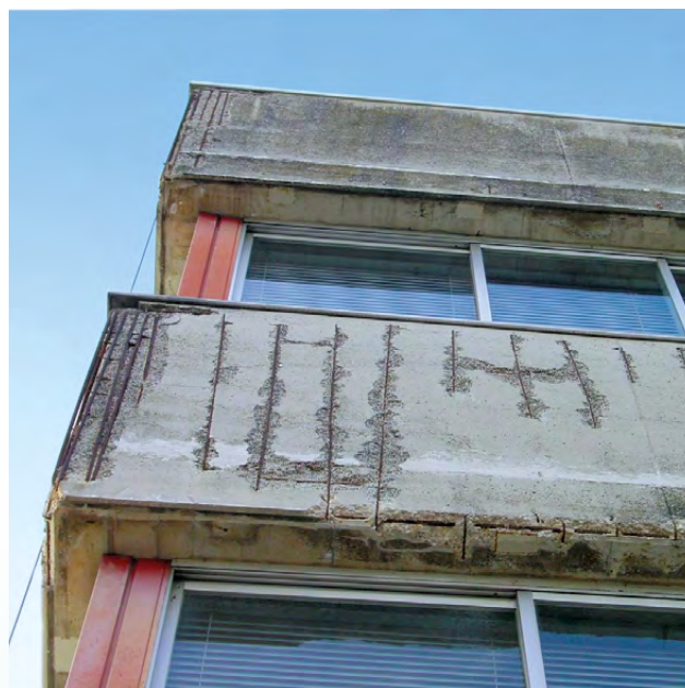
BÉTON PRÉSENTANT DES BARRES D'ARMATURE MISES À NU À LA SUITE DE LA DÉGRADATION
