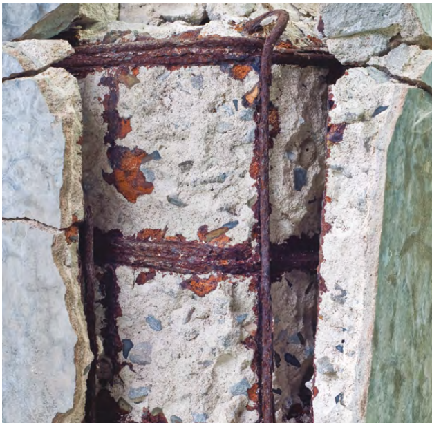
EXPULSION DE L'ENROBAGE À CAUSE DE LA ROUILLE DES BARRES D'ARMATURE
