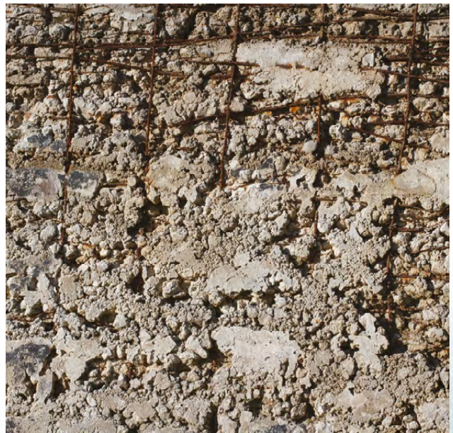
EXEMPLE DE SÉGRÉGATION DES GRANULATS DANS LE BÉTON
