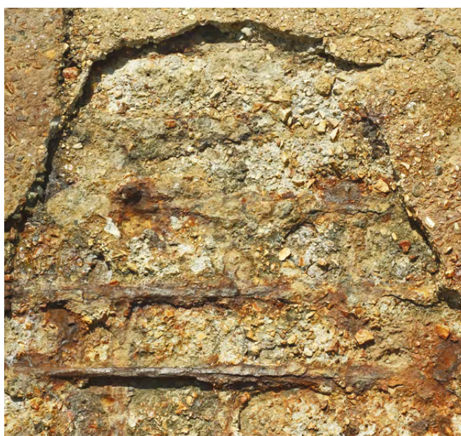
EXEMPLE DE CORROSION DUE À L'ATTAQUE PAR LES CHLORURES
