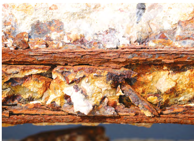
EXEMPLE DE DÉGRADATION DU BÉTON DUE À LA CORROSION DES BARRES D'ARMATURE
